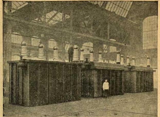
3 Transformatoren für 110000 V Obersp. in betriebsfertigem Zustand. Links 6000 kVA, daneben 2 Stück je 16000 kVA. Bayernwerkslieferung
