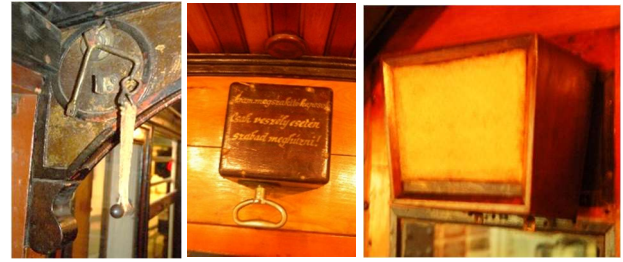
Fig. 12.: Alarm rod – emergency breaker – loudspeaker (URM)
